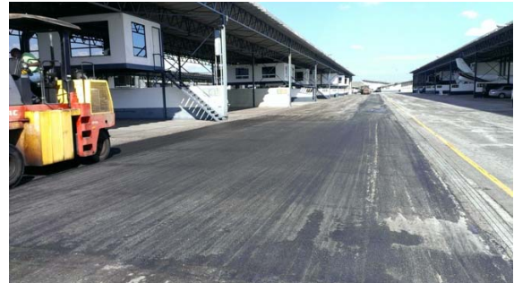
Bacheo en Calle de Rodaje
