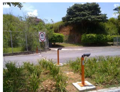
Cámaras para placas de vehículos
